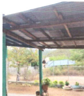
ESTRUCTURA DE TECHO, SUSTITUCION ESTRUCTURA EN MAL ESTADO
