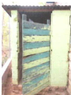
PUERTA, SUSTITUCION DE PUERTA EN MAL ESTADO
